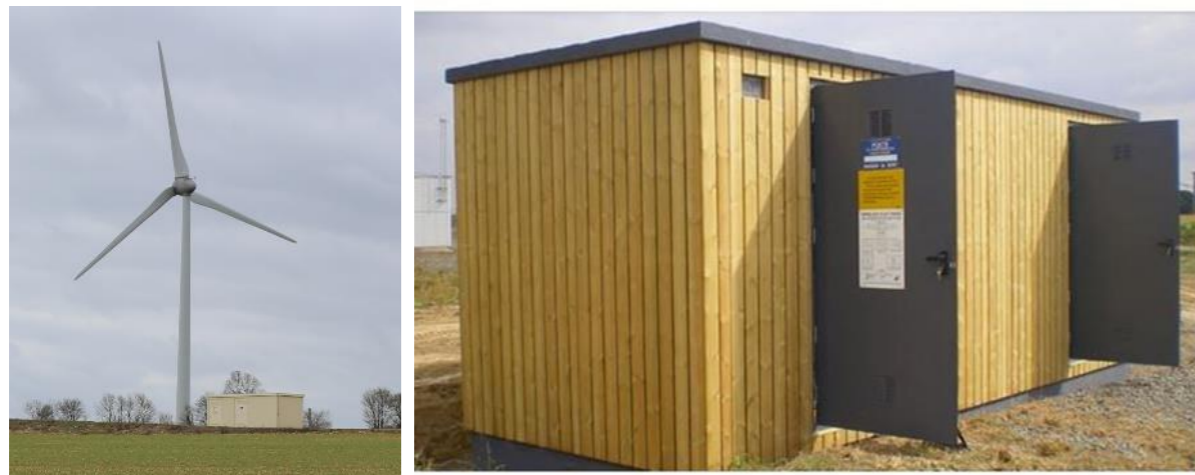
Photo 5 : exemples de poste de livraison électrique
