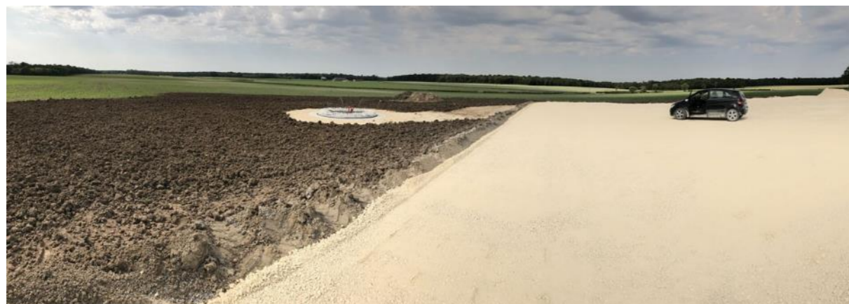
Photo 3 : exemples d'aires de grutage
